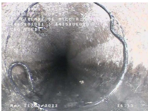
Joint d'étanchéité apparent - anneau d'étanchéité - pénétrant et rompu D17 – Saint-Étienne-de-Montluc
