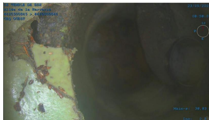
Assemblage - Dégradation de surface par abrasion, paroi manquante Allée de la Herverie – Le Temple-de-Bretagne
