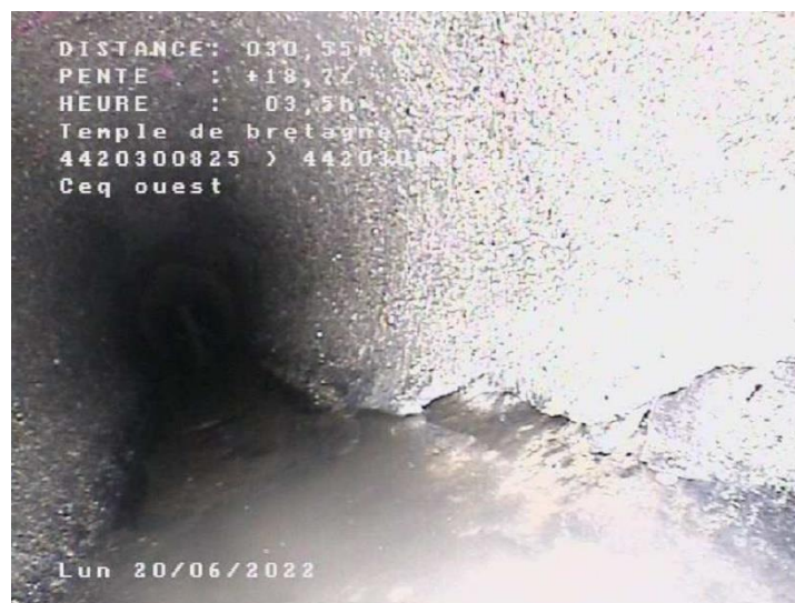
Dégradation de surface - Paroi manquante Rue de la Métairie – Le Temple-de-Bretagne
