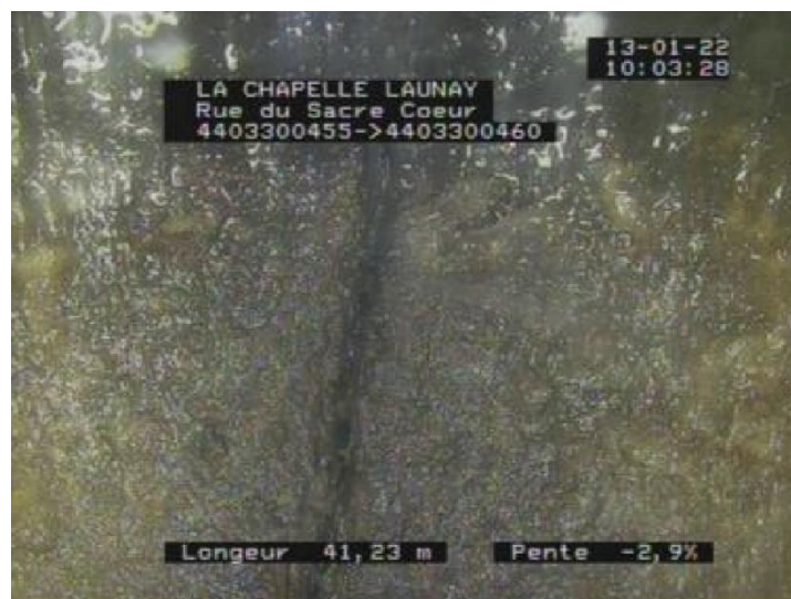
Assemblage - Fissure circumférentielle ouverte Rue du Sacré-Cœur – La Chapelle-Launay
