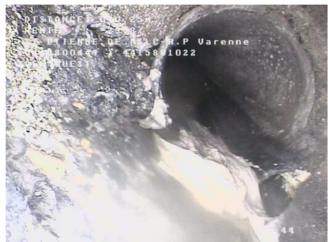
Regard 4415801022 : Effondrement – Rue Piron de la Varenne à Saint-Étienne-de-Montluc
