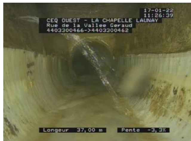
Regard 4403300462 : Infiltration par jaillissement au niveau du radier – Rue de la Vallée Géraud à La Chapelle-Launay
