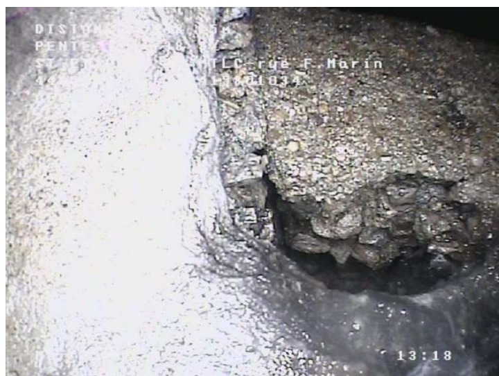
Rupture / Effondrement - effondrement partiel Rue Jean-Baptiste Ceineray – Saint-Étienne-de-Montluc
