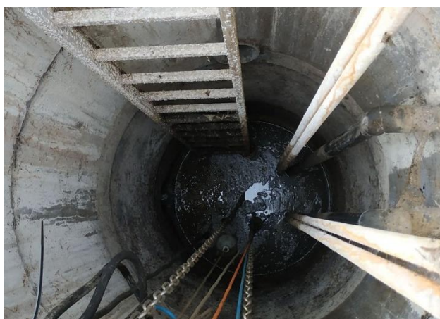
Figure 34 : Photographie du trop-plein sur le poste de relevage Mazarettes à Cordemais
