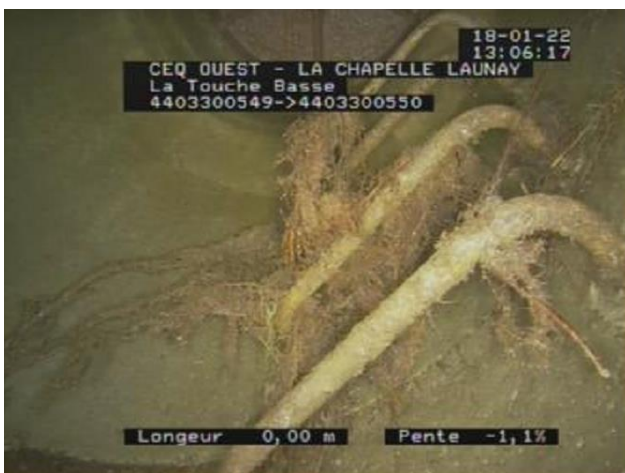
Regard 4403300549 : Ensemble complexe de racines – La Touche Basse à La Chapelle-Launay
