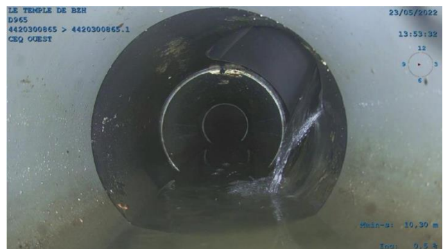
Infiltration par jaillissement - au niveau du branchement Rue Georges Bonnet – Le Temple-de-Bretagne
