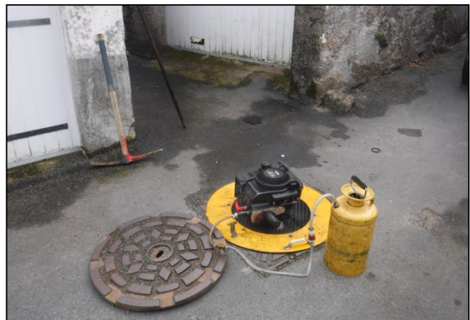
Ventilateur injectant de la fumée au niveau d'un regard
