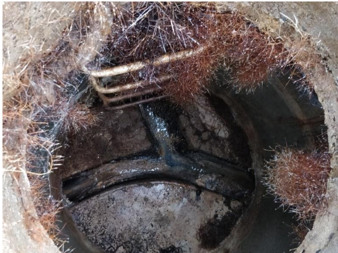
Figure 29 : Quantité importante de racines, traces de mises en charge - Malville
