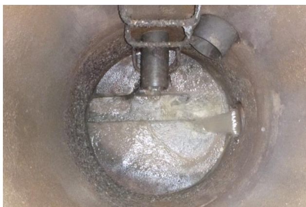
Trop-plein sur le réseau séparatif rue de Donges à Prinquiau
