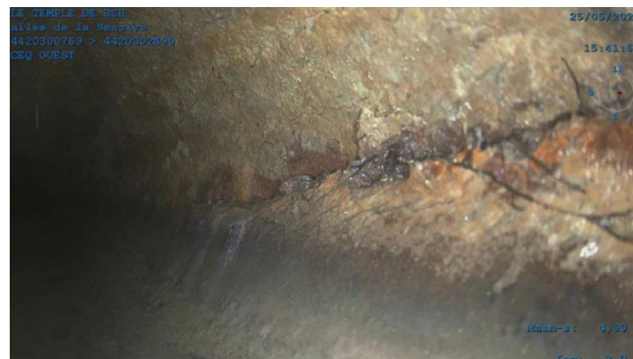
Fissure longitudinale ouverte Allée de la Sencive – Le Temple-de-Bretagne
