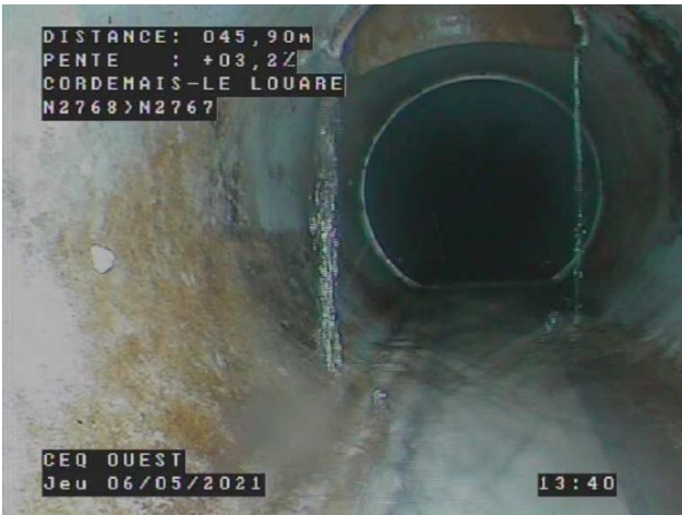
Infiltration - écoulement Le Louaré - Cordemais
