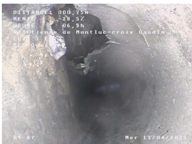
Dégradation de surface - paroi manquante - mécanique - inspection impossible La Croix Gaudin – Saint-Étienne-de-Montluc
