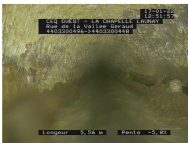
Effondrement total - Inspection abandonnée - Progression impossible Rue de la Vallée Géraud – La Chapelle-Launay
