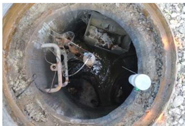
Trop-plein sur le réseau séparatif rue Georges Bonnet au Temple-de-Bretagne
