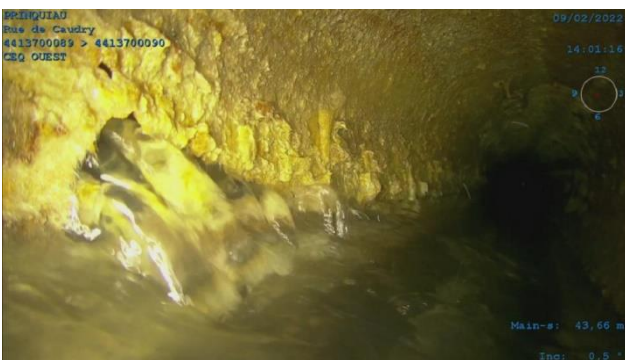
Infiltration par écoulement continu Rue de Caudry – Prinquiau
