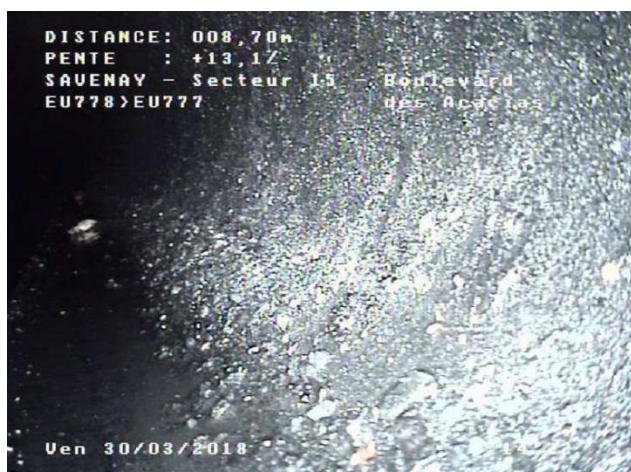
Dégradation de surface - écaillage - chimique Boulevard des Acacias – Savenay
