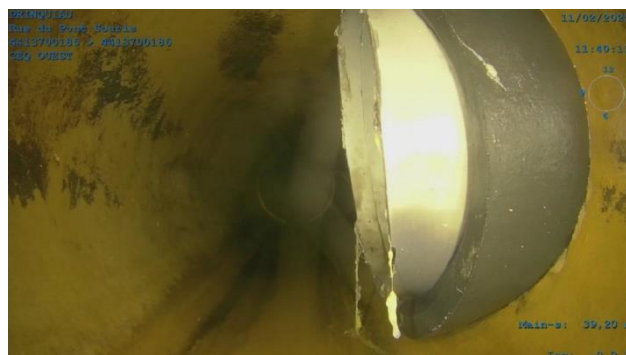
Inspection abandonnée à cause d'une obstruction - branchement pénétrant Rue du Pont Souris – Prinquiau
