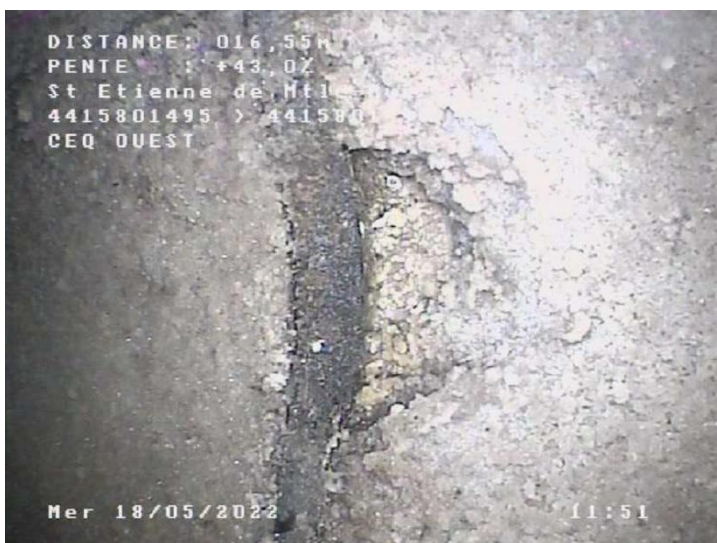
Dégradation de surface - Paroi manquante - mécanique Rue de Nantes – Saint-Étienne-de-Montluc
