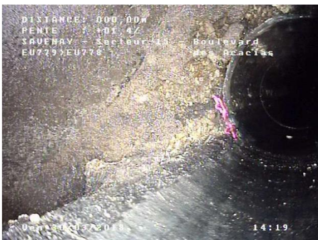
Regard 4419503512 : Dégradation de surface - paroi manquante - chimique générale – Boulevard des Acacias à Savenay
