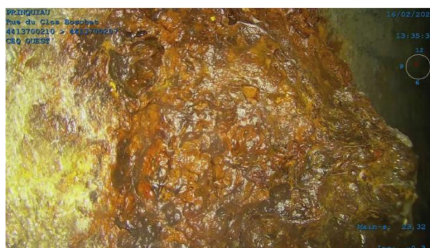
Dégradation de surface par attaque chimique générale, produits corrosifs sur la surface Rue du Clos Boschet - Prinquiau
