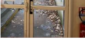
Stores intérieurs dégradés
