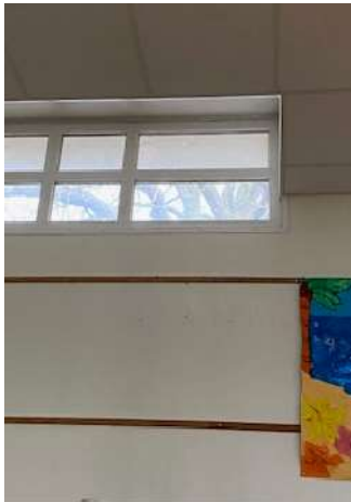
Placo au droit des stores détériorés
