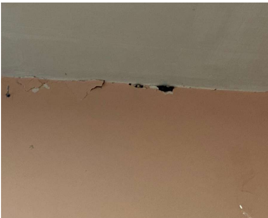
Haut du mur fissuré avec présence d'aciers
