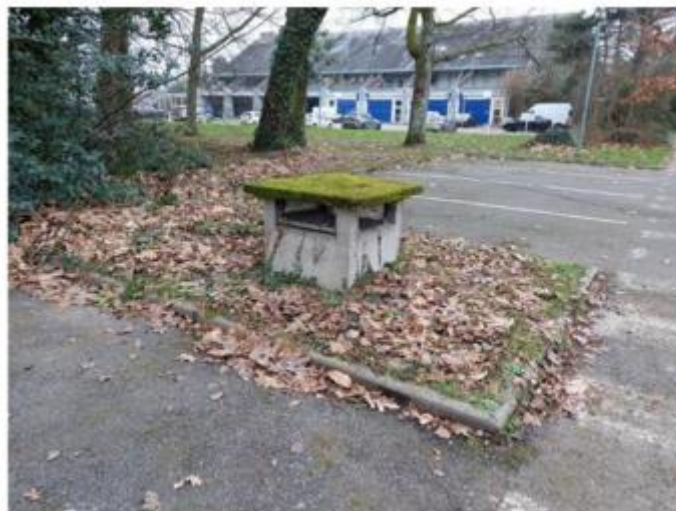
Figure 40- Cheminée d'aération du réseau souterrain
