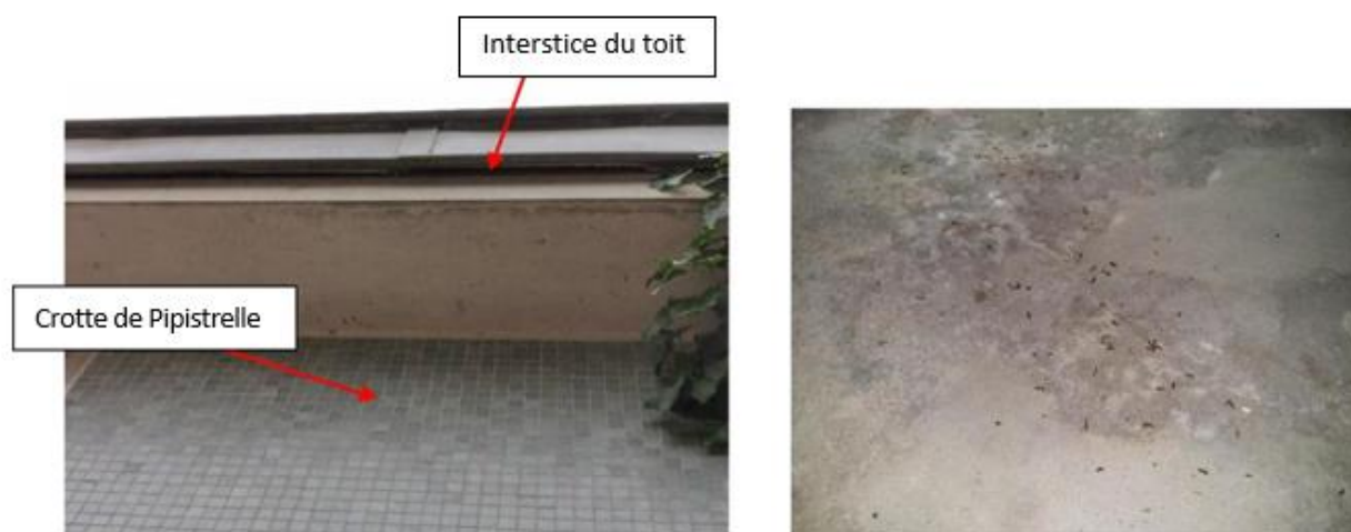
Figure 36- A gauche, interstice du toit utilisé par les chiroptères et à droite, guano d'Oreillard trouvé dans les combles
